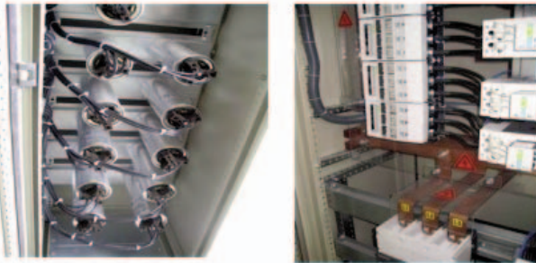
Şekil 5. Bozkaya taşkıma tesisinde uygulanan mekanik anahtarlamalı kondansatör gurupları.
